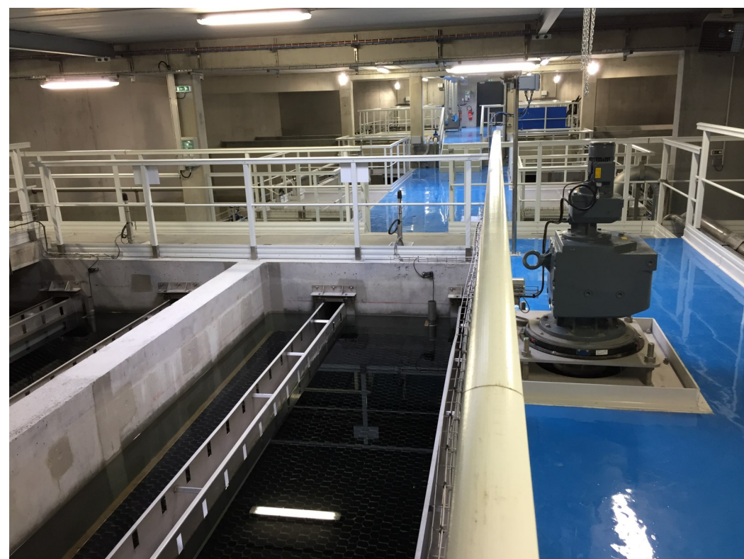
Plan d'eau à l'intérieur de l'usine au niveau R+1.
